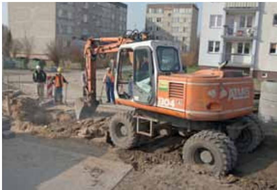
Zadanie VI A os. Olimpijskie – budowa odcinka kanalizacji sanitarnej (fot. Wojciech Lastowski)
