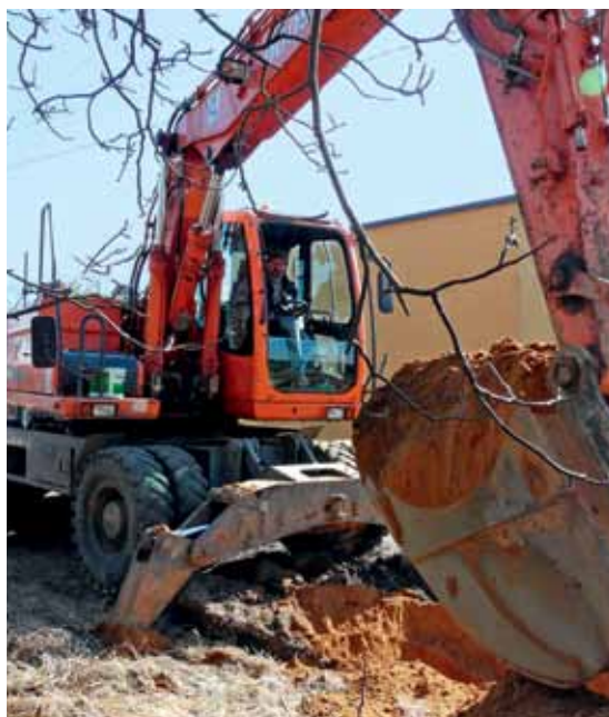
Kontrakt nr 5 – po realizacji – fot. PWiK Żory Sp. z o.o.
