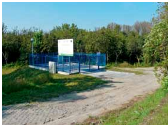
Tłocznia ścieków. Kontrakt K-5/WV Budowa sieci wodociągowej i kanalizacji sanitarnej na terenie osiedla mieszkaniowego: Wrzosy i Torunia Południowego” (fot. Piotr Rabant)
