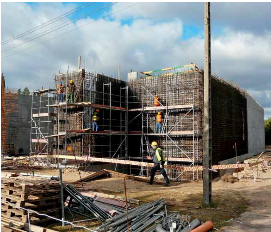
Budowa zbiornika wyrównawczego o pojemności 5500 m 3 . Kontrakt K-3/W pn. Modernizacja Stacji Uzdatniania Wody „Mała Nieszawka” (fot. Piotr Rabant)
